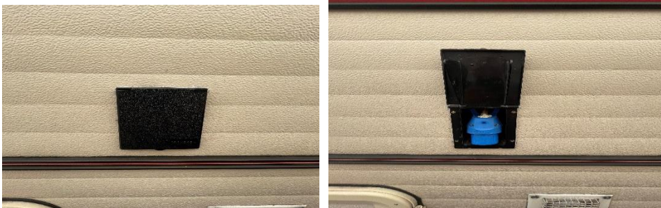
(afb. 14) netstroom aansluiting
